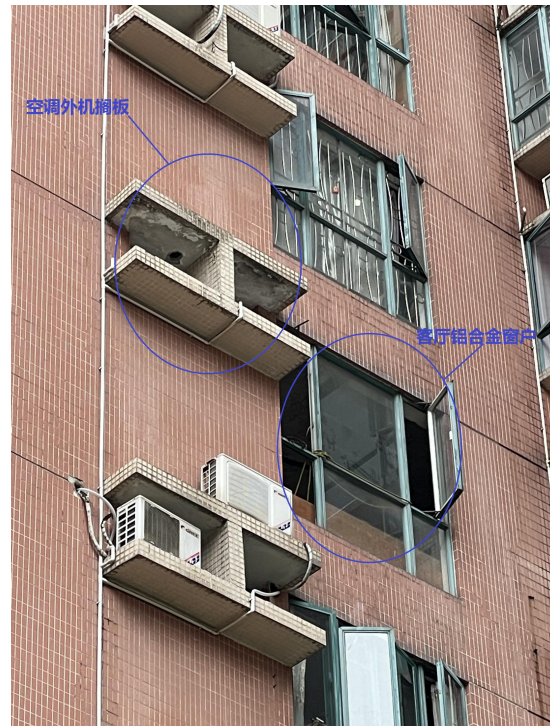
(图6 次卧外墙空调外机搁板)
