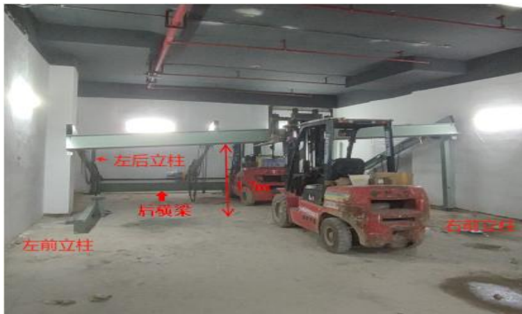
图5 现场上框架组滑落状态
