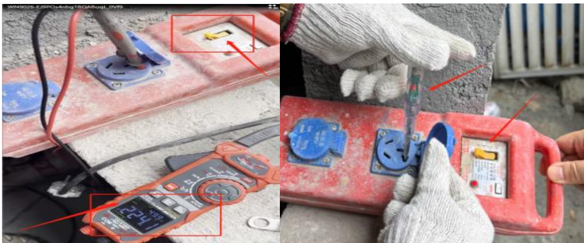
图 15、16 开关在断开位置开关出线端有电
