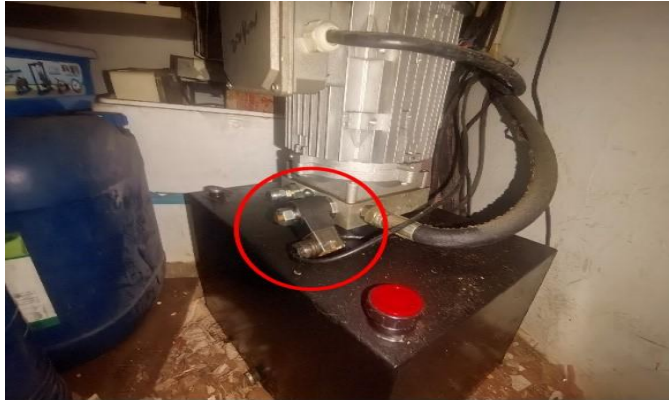
图 18 液压泵站上的电磁换向阀图
