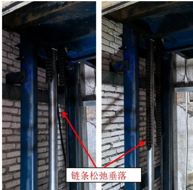
图 37、图 38 液压缸持续回缩链条完全松弛状态
