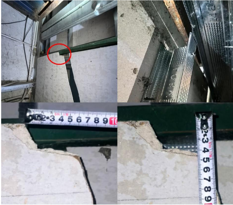
图 30、图 31、图 32、图 33 隔墙板故障情况图
