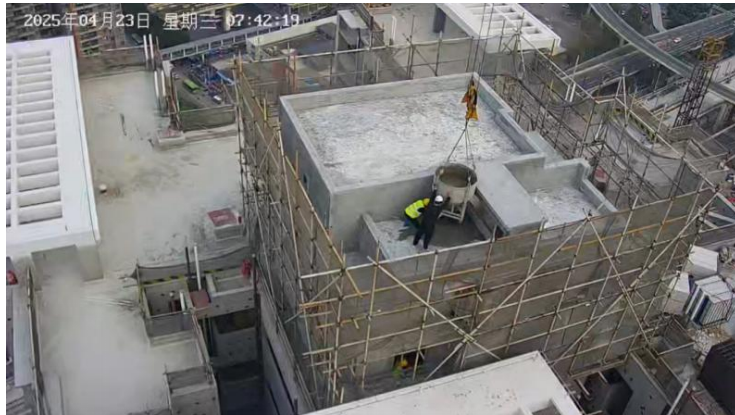
图8 7时41分，陈某再次站在D栋机房顶卸料 (图显时间约快1分钟30秒)
