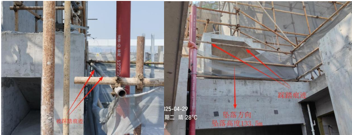
图 20、21 坠落点位勘察情况
