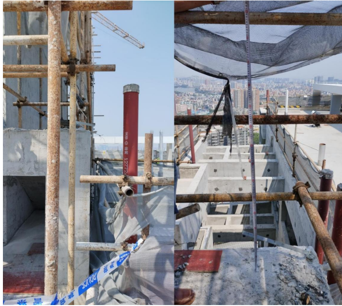
图 17 事发部位楼梯平台防护情况
