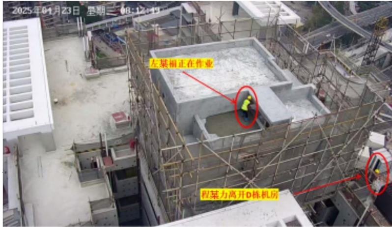
图9 8时11分，程某力离开D栋机房前往D栋机房作业 (图显时间约快1分钟30秒)
