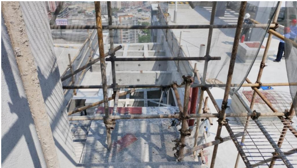
图 15 事发部位屋面防护情况
