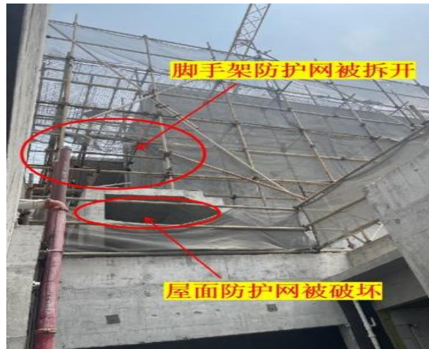
图 18 事发后第一时间防护网的情况
